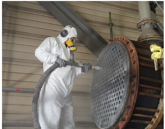
» Grafitni izmenjevalci toplote z lupino in cevmi predstavljajo poseben izziv za čiščenje. Na sliki je izmenjevalec toplote z notranjo površino cevi 84 m 2 in volumnom 674 litrov, medtem ko je celoten volumen izmenjevalca 3.800 litrov. Med čiščenjem je nastalo 45 litrov odpadkov, ki so sestavljeni iz uporabljene čistilnega medija in odstranjenih nečistoč. | Vir: mycon
